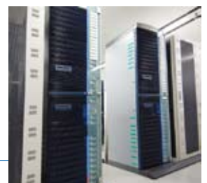
UFJIS サーバー・ルーム
